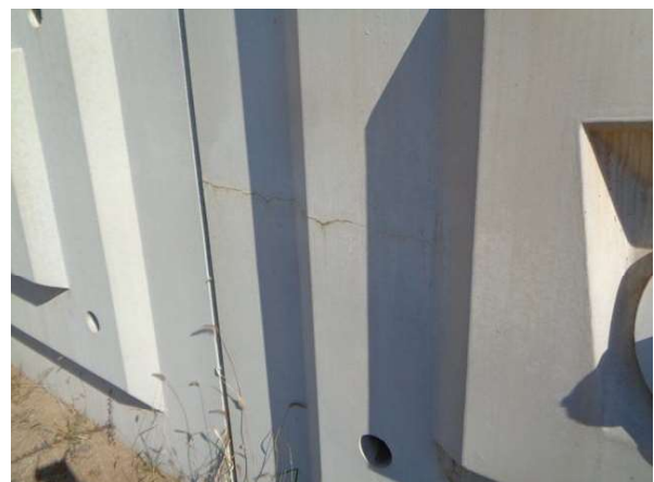
전면부 S3 균열(Cw=0.3mm미만)
