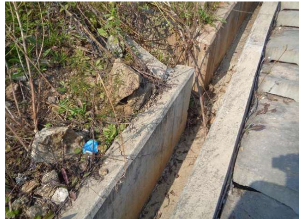
주변영향인자 S2 균열 (Cw=0.3mm이상)
