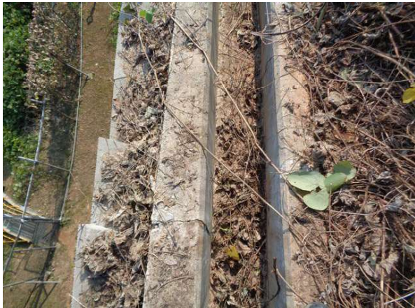
주변영향인자 S2 균열 (Cw=0.3mm이상)
