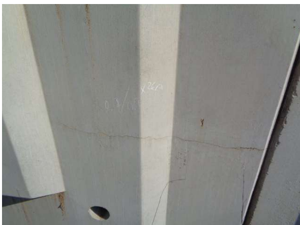
전면부 S3 균열(Cw=0.3mm미만)
