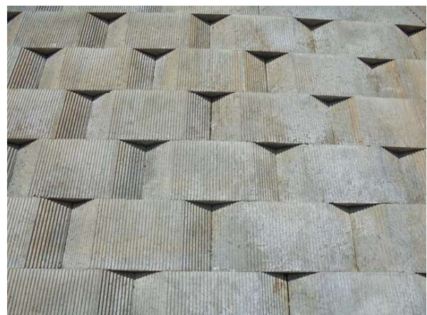
전면부 S4 블록 균열
