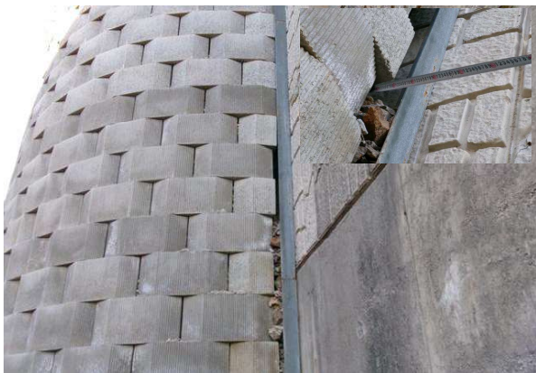
주변영향인자 S18 옹벽 내부 충전물 유실(22년)
