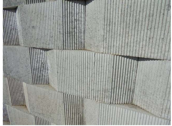
전면부 S3 블록 균열
