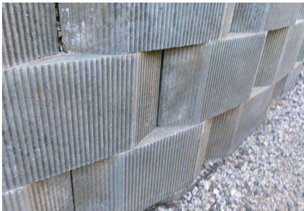
전면부 S17 블록 균열
