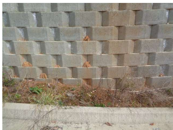
전면부 S5 블록 균열
