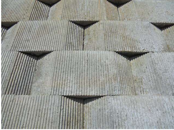
전면부 S3 블록 균열
