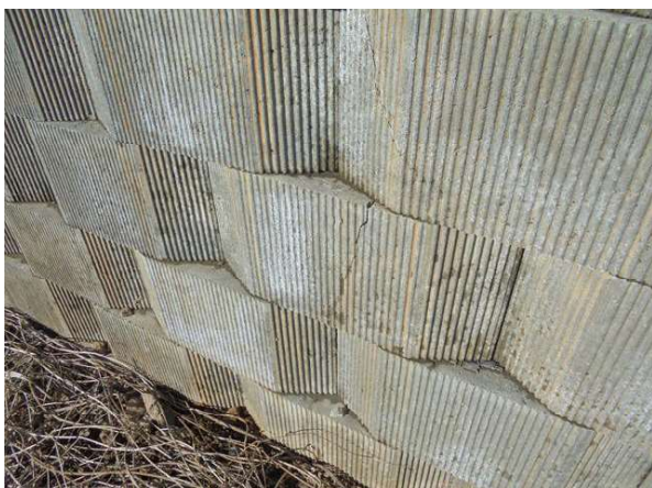
전면부 S2 블록 균열
