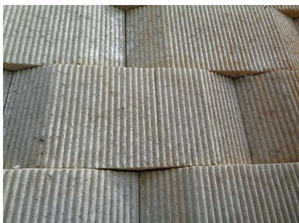
전면부 S5 블록 균열
